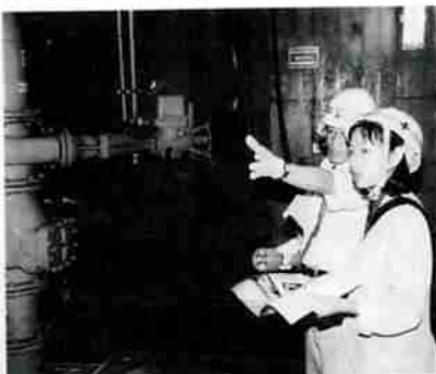
▲若山浄化センター ポンプ室
