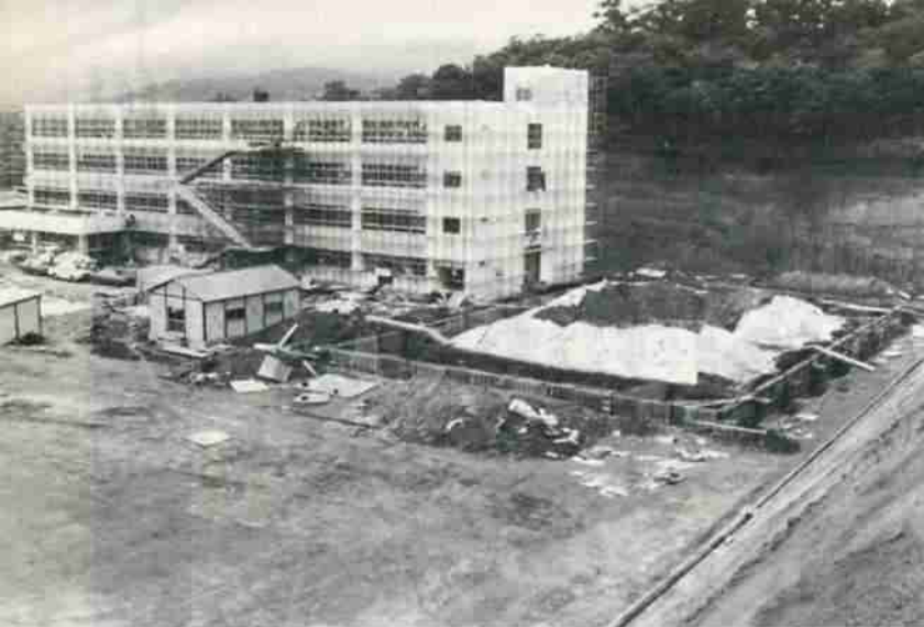
《仮称・鷺中分教場建設工事》 屋内運動場の工事が初まりました。写真・右手前—昨年度からの2ヶ年継続事業で建設され、来年4月開校の予定です。
