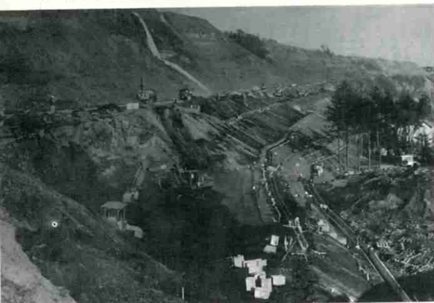
12月下旬開通を目指し、ハイビッチで復旧工事が進められている国道36号線、富浦付近。
