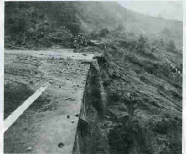
土砂に埋もれ、法面が崩れた国道（富浦町附近の新道）
