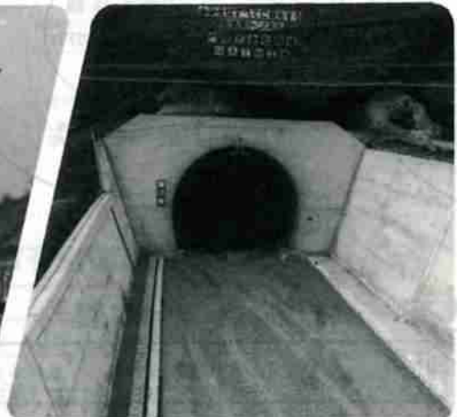
電化工事のため蘭法華トンネル近くの線路が、一部切り換えとなります。旧トンネルの隣りに新しいトンネル工事が急ピッチで行なわれています。
