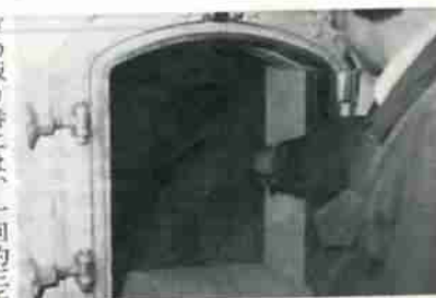
炉内—階段ストーカーの上で適度に反転、焼却されます
