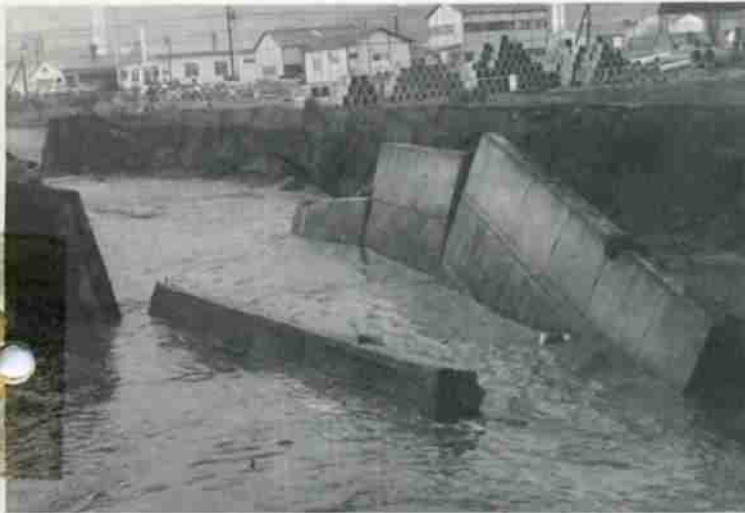
河川決壊で泥流と共に押し流される岡志別川のコンクリート壁
