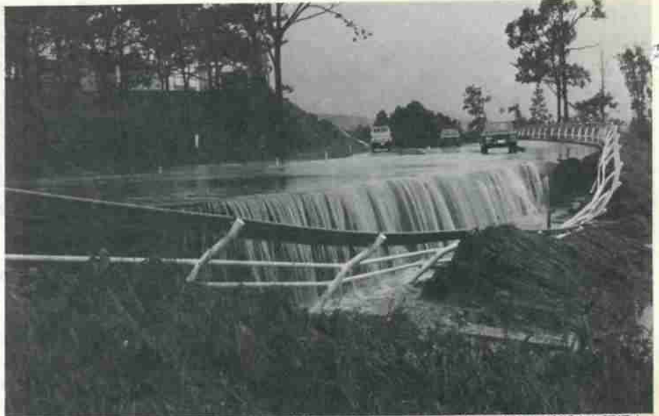
市内を襲った集中豪雨は、国道、道々、市道をも破壊し、10力所の道路、橋梁が寸断され不通となりました。写真は青葉町の道々
