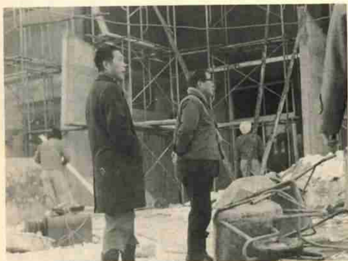
大きくなる養育所新設工事の作業員に「ごくろうさん、頑張ってください」と声をかけ、激励していました
