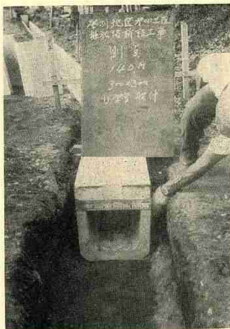
▲排水路新設工事 U字管敷設 勝間百貨店横からバス停まで外十六カ所 総工事費 一、九〇五万円
