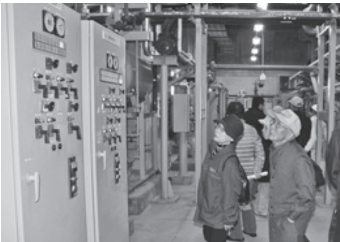
▲若山浄化センターを見学する参加者
