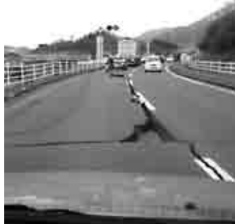
▼亀裂が生じた白石市内の道路
