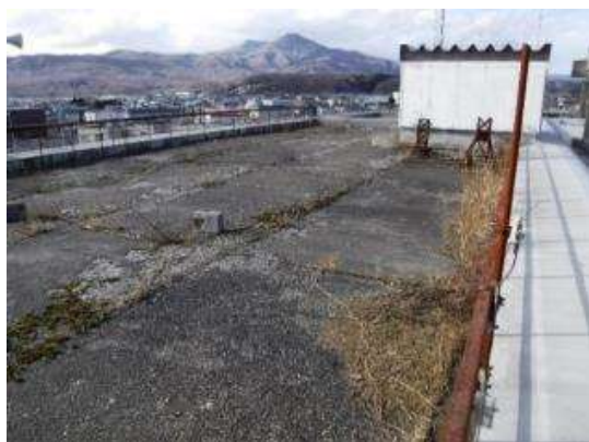
【写-10】老朽化等により剥離やひび割れなどが発生している庁舎屋上
