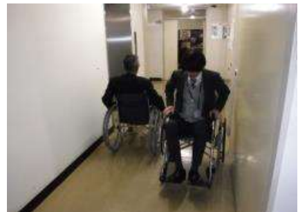
【写-15】 車いすがすれ違うには困難な狭隘な廊下
