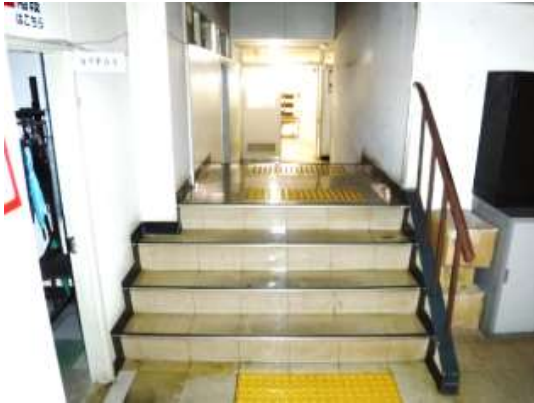
【写-25】 庁舎増築に伴い発生した廊下の段差
