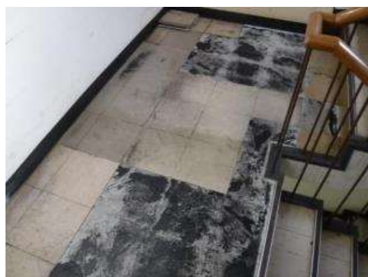
【写-13】庁舎階段踊り場の床タイルが剥離
