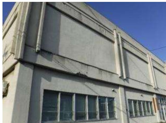
【写-11】第2庁舎（上記写真）においても老朽化が進み、外壁コンクリートの剥離が発生
