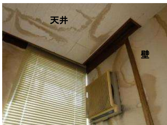
【写-12】庁舎内で慢性的に雨漏りが発生し、市長室においてもの雨漏りで壁クロスが変色
