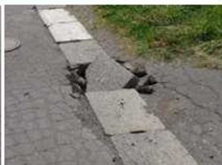
側溝のふた破損
