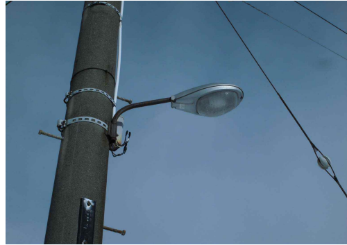
防犯灯（水銀灯）
