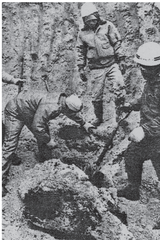
砂防工事川底の炭化木
