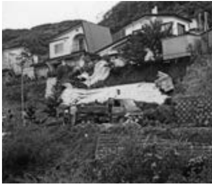
▲大雨によって崩れた擁壁
