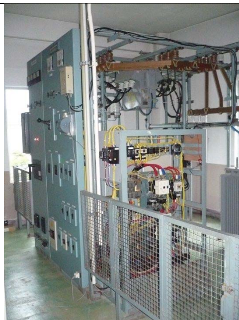
幌別浄水場 電気設備
