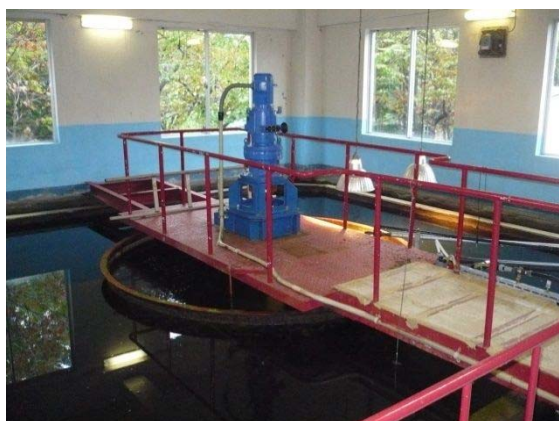
幌別浄水場 高速凝集沈澱池
